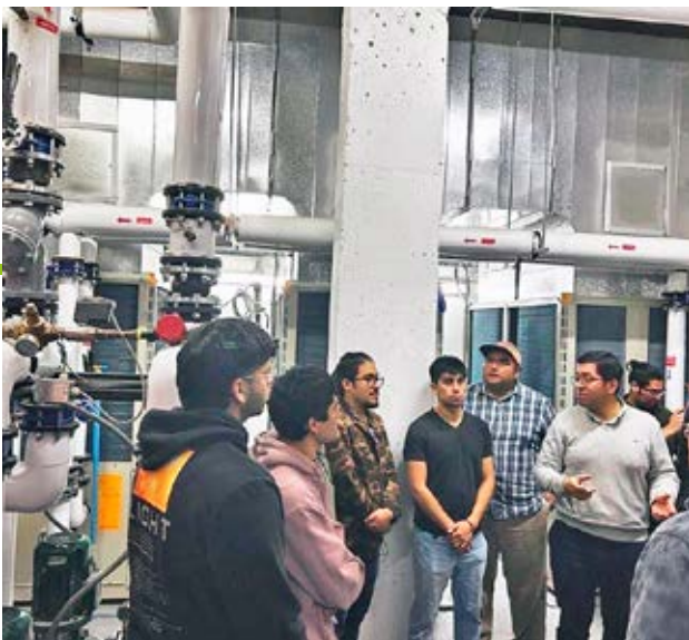
Visita Branch Usach a Central Térmica Ultraeficiente Full Electric de Energy Tracking S. A.
